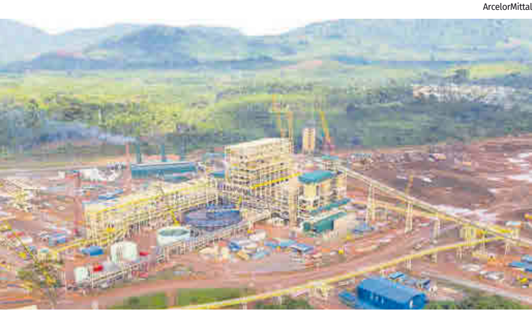
Las nuevas instalaciones de concentración de mineral de hierro de ArcelorMittal en Tokadeh (Liberia).
